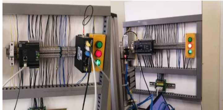
Figura 17: Funcionamiento de la comunicación y recolección de datos, para subirlos a la nube V-Box.
