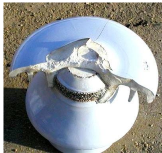
Figura 2. Rotura de un aislador.
