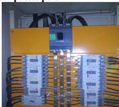
Figura 8. Tablero principal del bloque A
